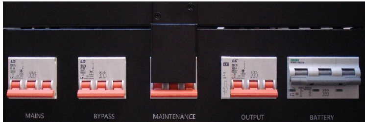
Abb. 3-16 Die Leitungsschutzschalter der USV-Anlagen (30 / 40 kVA) gekennzeichnet von links nach rechts mit: MAINS, BYPASS, MAINTENANCE, OUTPUT, BATTERY.
